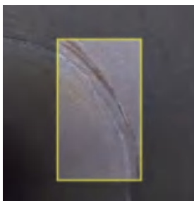
管道破损识别
